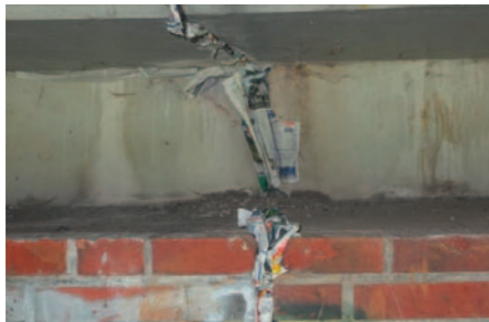
Schließen von möglichen Lebensräumen für Fledermäuse (li.), Überflughilfen (re.)
